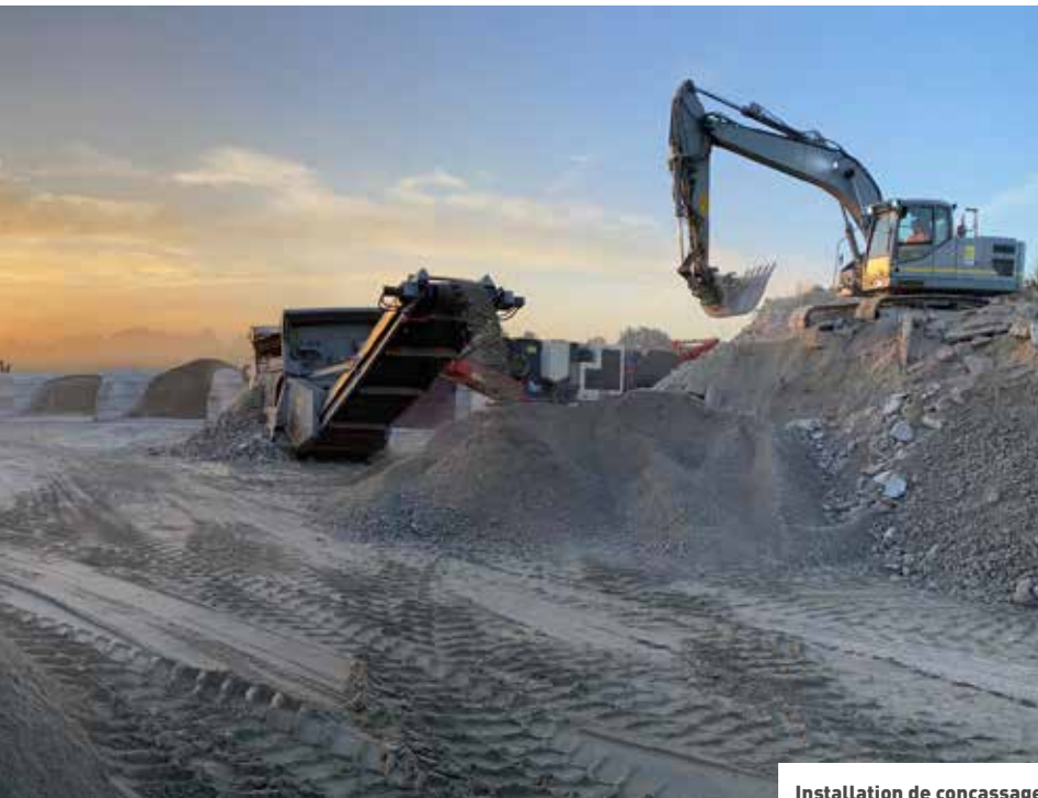
Installation de concassage
