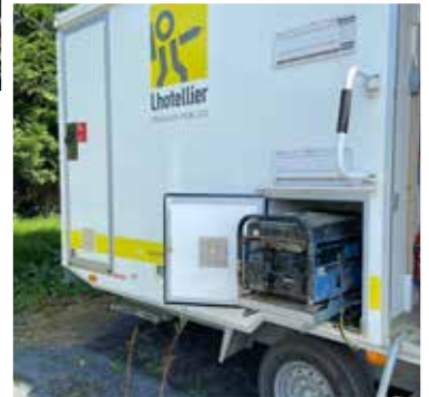
Groupe électrogène sur rail coulissant
