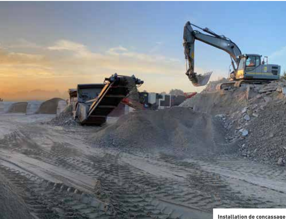
Installation de concassage
