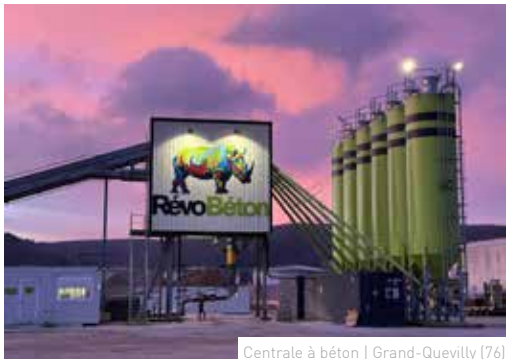
Centrale à béton | Grand-Quevilly (76)
